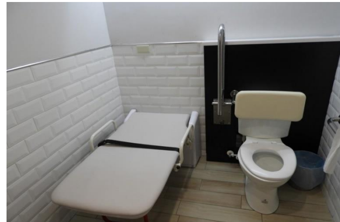
無障礙廁所內設置照護床
